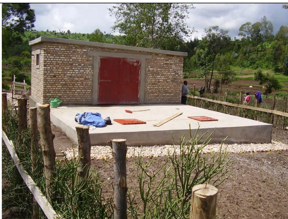
Riserva da 40'000 litri e magazzino sala pompe
